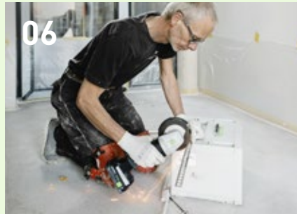
Se cortan los rieles de conexión a medida con la amoladora angular AGC 18 y se aplican como juntas de dilatación.
