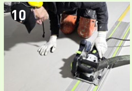
Se separan las juntas de dilatación con el DSC AG 125 y el riel de guía.
